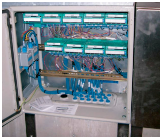
Bild 8: IS RPI im Schaltkasten.
