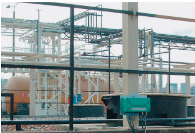
Bild 17: FieldBarrier in rauher Umgebung in einer Anlage der Öl- und Gasverarbeitung in Ungarn.
