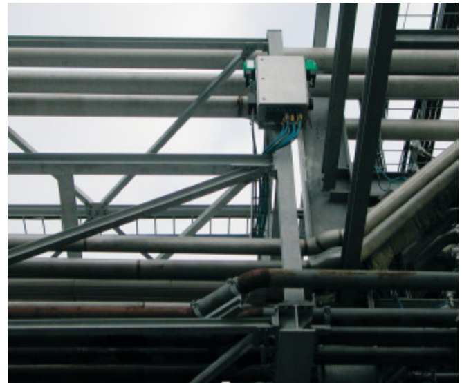
Bild 12: RIO-System an der Applikation.
