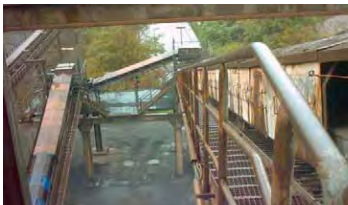
工厂外部的电缆
