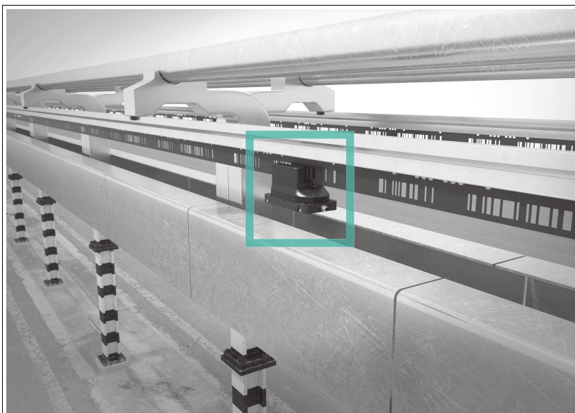
Abbildung 2.5 Stromschiene eines Portalkrans
