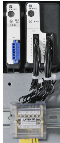
Abbildung 3.20 Feldverdrahtung eines E/A-Moduls mit 2 Kabelschwänzen
