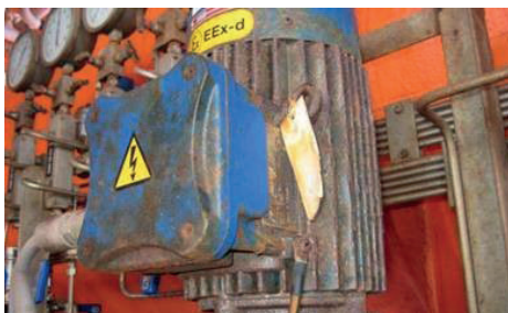
Beispiel für Korrosion durch Chemikalien Quelle: thuba AG
