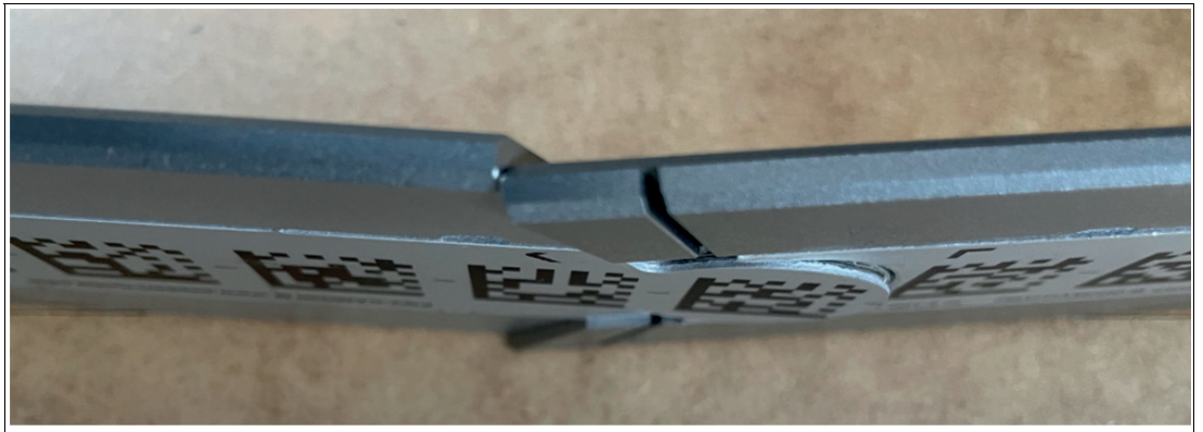
Abbildung 6.6 Versenkprofilschienen nach außen geknickt Beides gilt auch für die Überfahrprofilschienen.
