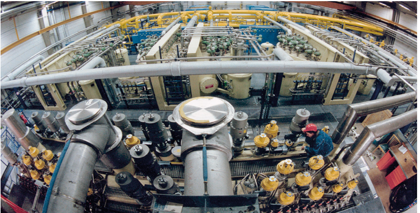
Der größte Kühltank Europas: die Kälteanlage beim DESY in Hamburg
